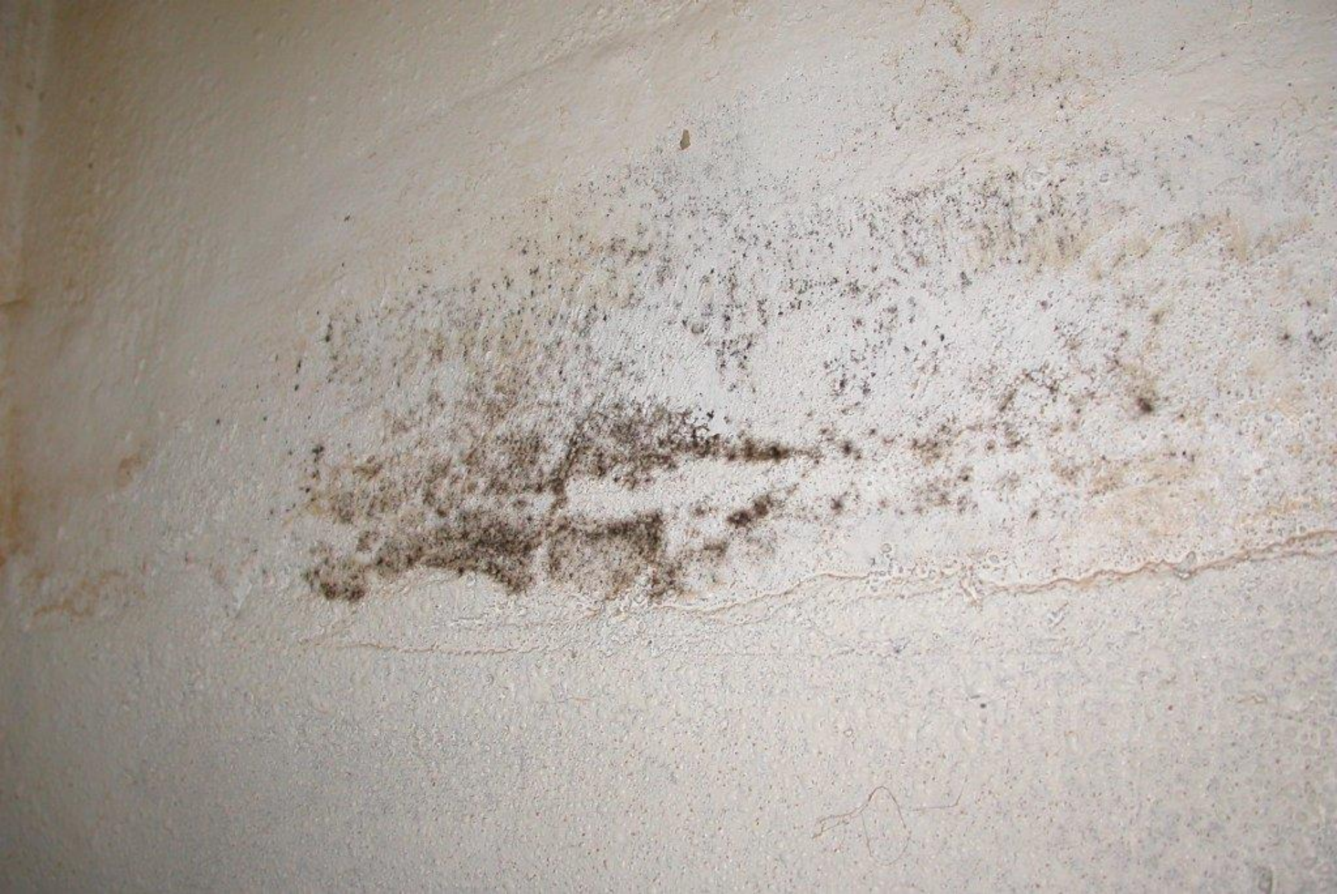
Tmavé nárosty na stěně na jednom místě nad hladinou
